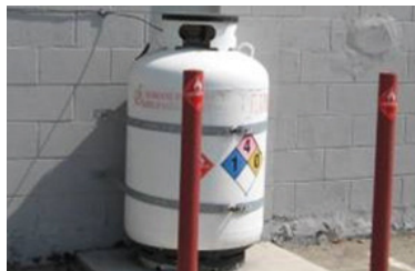
壁と固定された可燃性液体タンク
