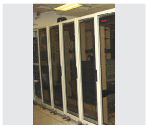
Soportes de servidores informáticos anclados al piso
