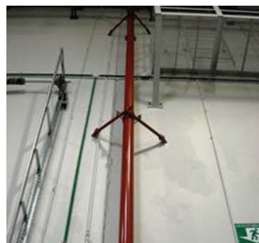
Tubería de rociadores con soporte antisísmico
