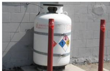
An der Wand befestigter Behälter für brennbare Flüssigkeiten
