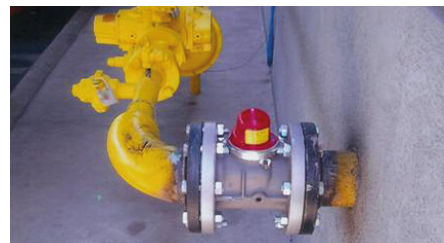
Erdbeben-Sicherheitsventil in der Gasversorgung
